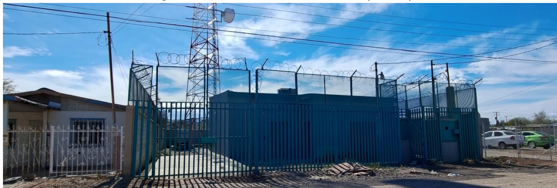
Figura 137: Unidad remota de líneas Telnor (COM-01)
