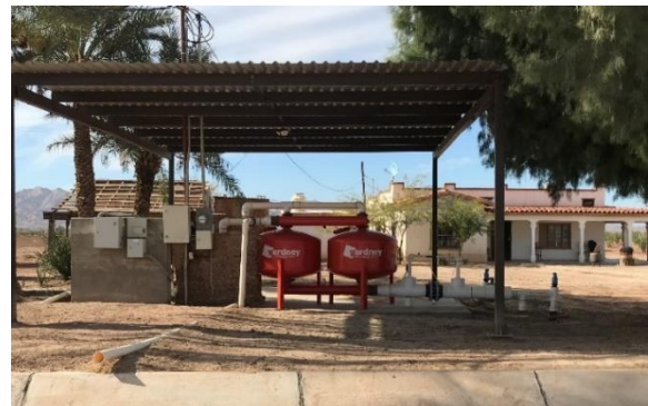
Figura 103: Planta potabilizadora en rancho datilero.
