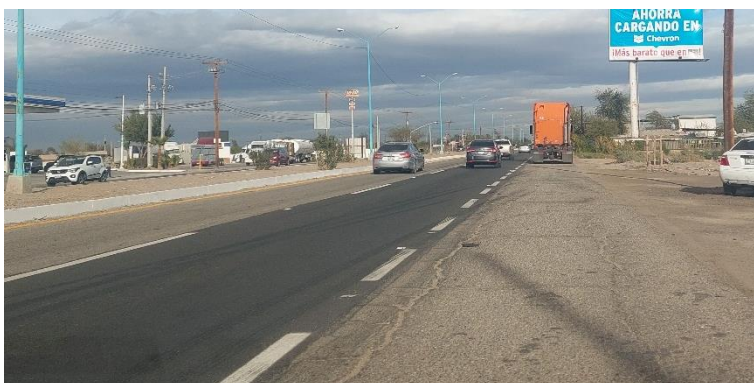
Figura 78: Calz. Coronel Esteban Cantú, estado regular, vista al oeste.
