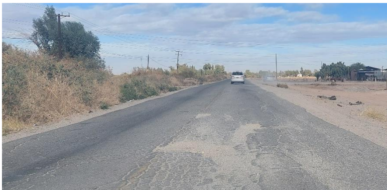
Figura 79: Carr. Ejido Heriberto Jara en mal estado, vista al sur.
