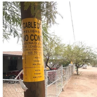
Figura 117: Señalización en poste de la entrada de fibra óptica en Col. Pioneros de la Progreso.
