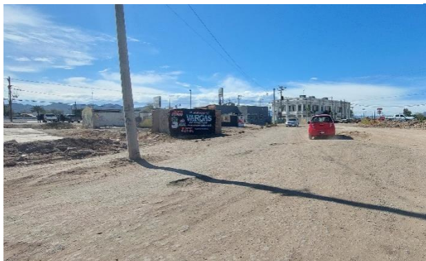
Figura 81: Estado de la vialidad en el acceso a la av. Lázaro Cárdenas del Poblado Progreso desde la carr. Progreso-Sta. Isabel.
