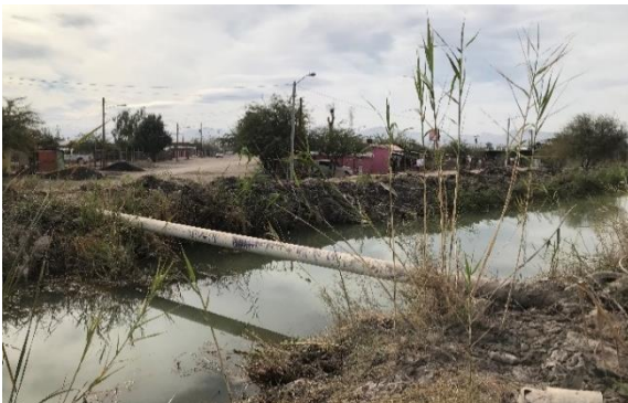
Figura 104: Tubería de 20" de diámetro en Poblado Progreso
