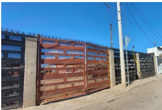
Figura 90: Diseño inadecuado y obstrucción de las banquetas en la colonia Jardines de la Progreso calle Diagonal Centinela.
