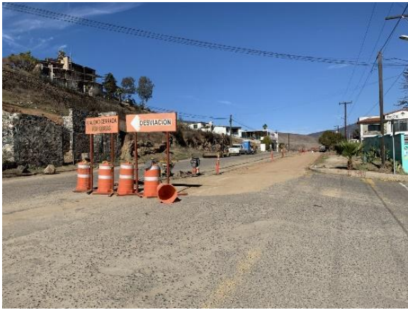
FIGURA 45 SEÑALAMIENTO DE OBRA EN LA VÍA PÚBLICA SIN NORMATIVIDAD
