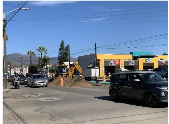
FIGURA 46 RUPTURA DE PAVIMENTO RECIÉN HABILITADO PARA INTRODUCCIÓN DE INFRAESTRUCTURA
