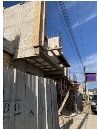
FIGURA 40 INVASIÓN LA VÍA PÚBLICA CON VOLADIZOS Y TAPIALES
