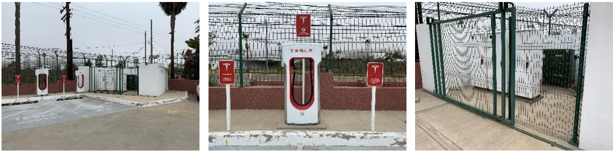
FIGURA 97 ESTACIÓN PRIVADA PARA CARGA DE AUTOS ELÉCTRICOS EN HOTEL DE LA LOCALIDAD
