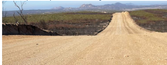
Ilustración 21. Trazo liberado y nivelado para la instalación del gasoducto dentro de los límites del área de estudio
