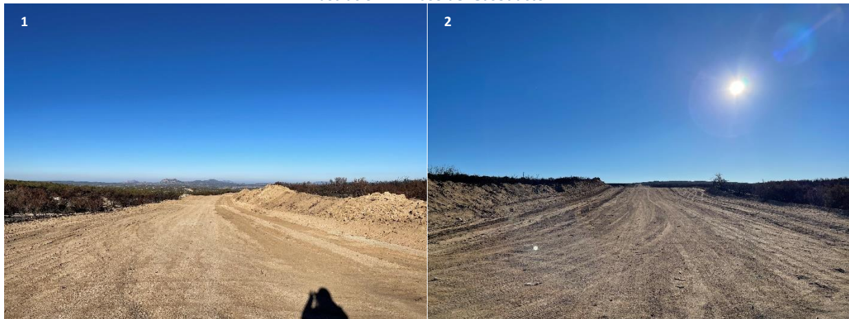
Ilustración 24. Paso del Gasoducto
