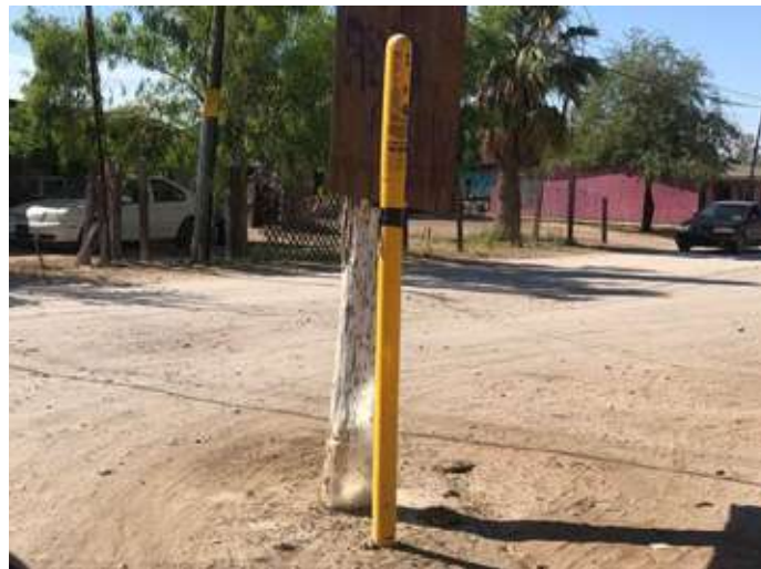
Figura 44. Fibra óptica TELNOR ejido Guanajuato.
