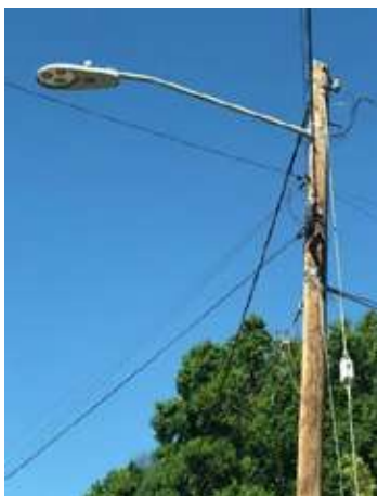
Figura 41. Alumbrado público ejido Michoacán de Ocampo.
