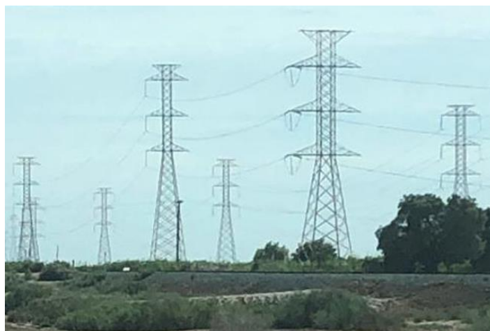
Figura 43. Red Eléctrica en área de estudio, al paralelo con carretera estatal #2 Mexicali-Los Algodones.
