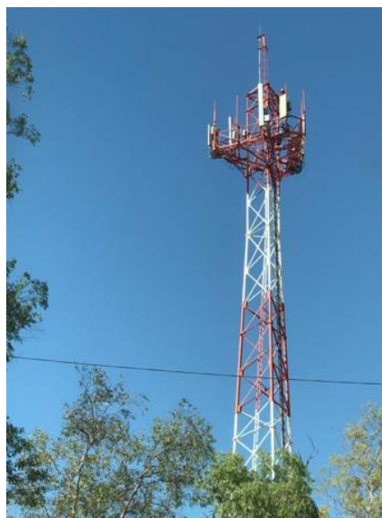
Figura 45. Antena de comunicación, ejido Michoacán de Ocampo.
