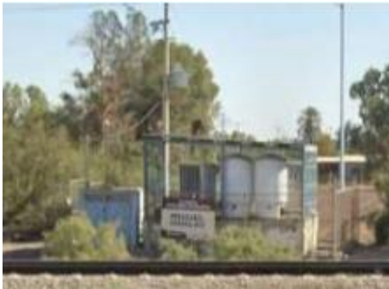
Figura 38. Planta potabilizadora de agua “Miguel Hidalgo”.
